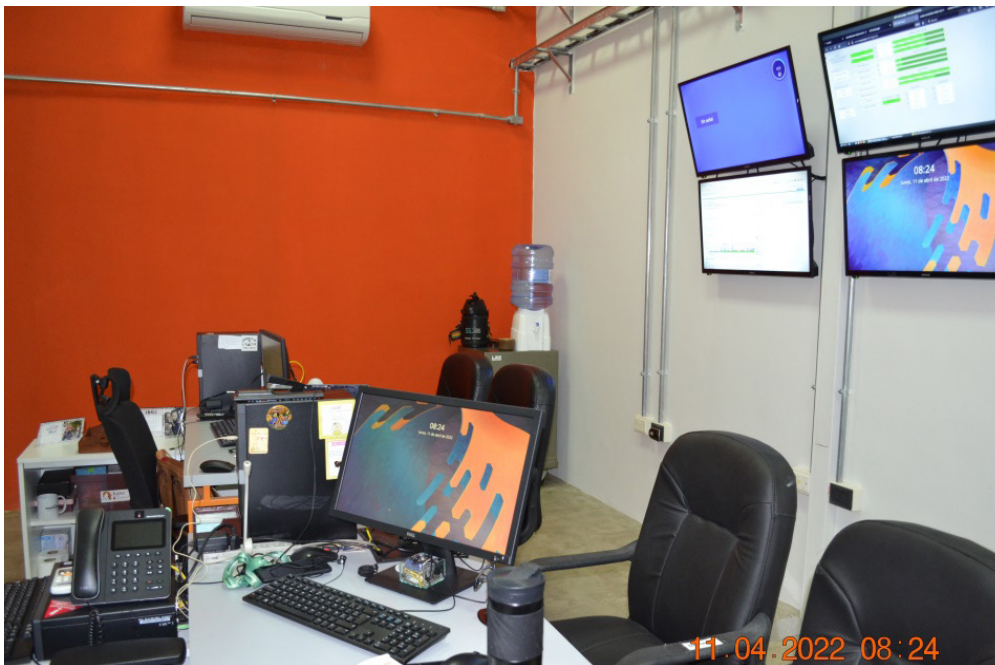
Vista general de la Sala de Monitoreo Centralizada
